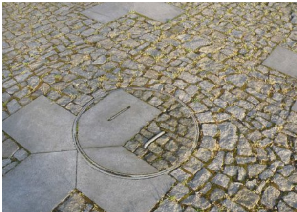
348 Vhodný povrch poklopu vstupu do kanalizační šachty v chodníku, který materiálově a výškově navazuje na okolní povrch [ Lázně Bohdaneč, Masarykovo náměstí ]
