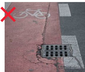
357 Nevhodné umístění vpusti dešťové kanalizace v rámci cyklopruhu; pro zvýšení bezpečnosti je alespoň dodatečně osazena mřížicí, do které kolo nezapadne [ Praha ]
