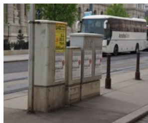
365 Skříň technické infrastruktury je vhodné umísťovat v ose sloupů, kde nepřekáží v prostoru, případně přecházení ulice [ Rakousko, Vídeň ]
