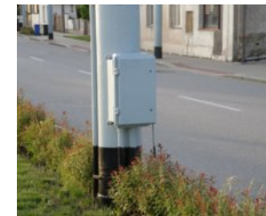
361 Minimalizovaná skříň umístěná na sloupu trakčního vedení, opatřená shodným nátěrem a nepřekážející v prostoru může být vhodnou náhradou samostatně stojící skříňě. Vždy je třeba navrhovat s ohledem na navazující prostranství [ Lázně Bohdaneč, Šípkova ]
