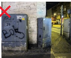
367 Nevhodné umístění skříní degradující kvalitu fasády a nároží domu [ Praha 7, Strossmayerovo náměstí ]
