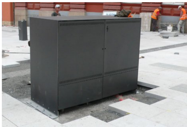
363 Příklad kvalitního vyřešení sdružování skříní technické infrastruktury a jejich architektonického ztvárnění v rámci kompozice celkového prostoru. Fotografie z realizace. A69 architekti [ Cheb, ul. Svobody, pěší zóna ]
